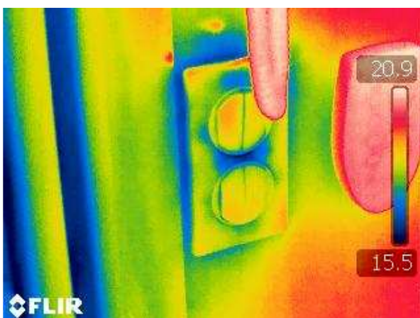
Infiltration au niveau d'un interrupteur
